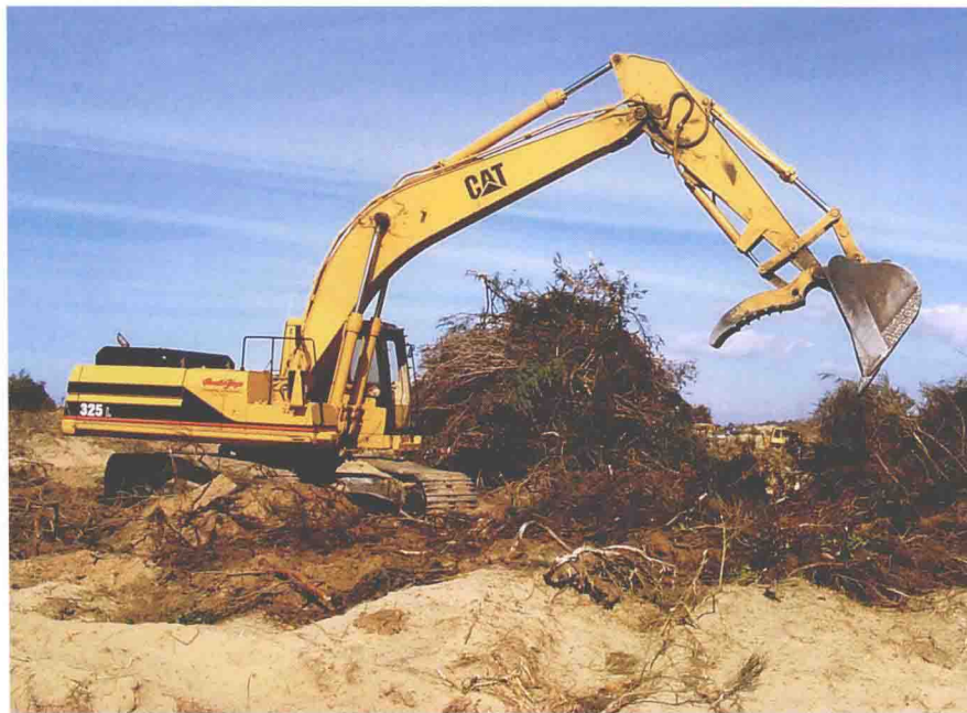
挖掘机的破坏
