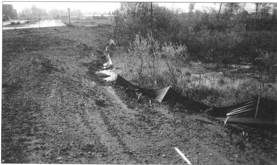
施工场地中的典型景象：已经被沉积物掩埋的泥沙栅栏
